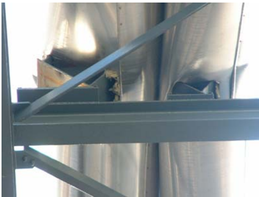
Abb. 1 Durch Druckstöße verursachte Schäden an einer Rohrbrücke (oben, aus der Halterung gesprungene Leitung, Chemiewerk b. Budapest, unten: beschädigtes Auflager)
