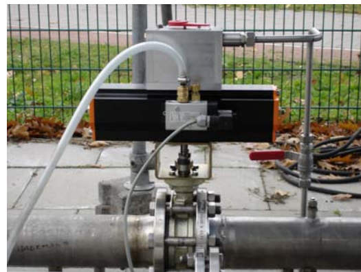
Abb. 3 PCD-System zur Vermeidung von Druckstößen in Rohrleitungen [6, 7, 8]
